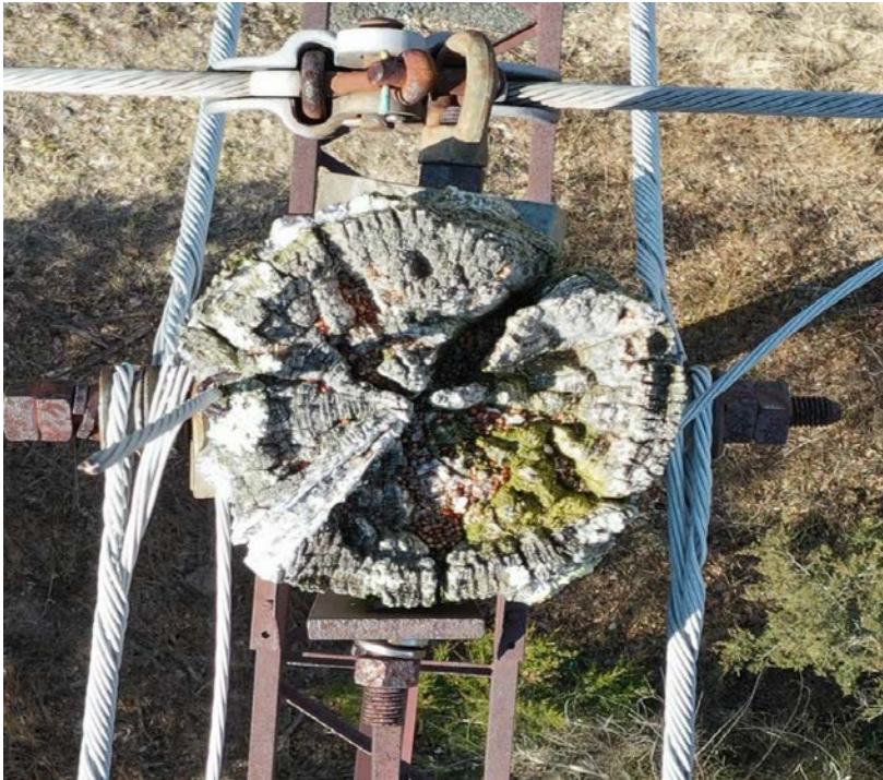
Pole Top Rot – Line 387
