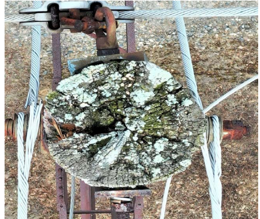
Pole Top Rot – Line 387
