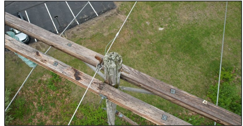
Line E194 Structure 42
