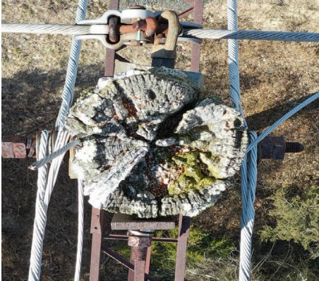
387 Pole Top Rot
